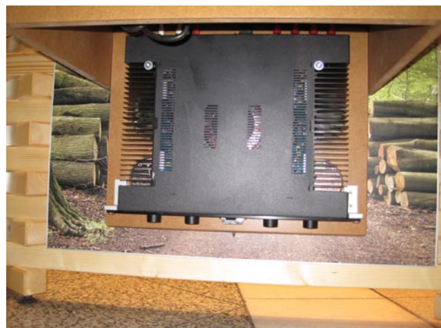
Auf der Klappeninnenseite befindet sich der 4-Kanalverstärker.
