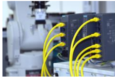
Abbildung 4: Siemens S615-Router und Siemens XC208-Switch (Quelle: Festo Didactic)
